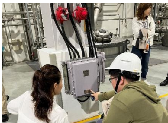
2025.03 化學材料製造業防爆電氣現場輔導-尤凱弘工程師(右)
