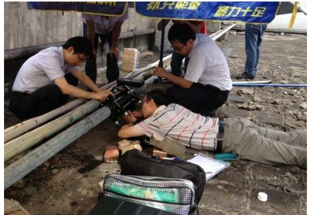
07.2013 製鞋業(中國廠區)能源管理輔導, 頂樓空壓機管線超音波流量現場量測
