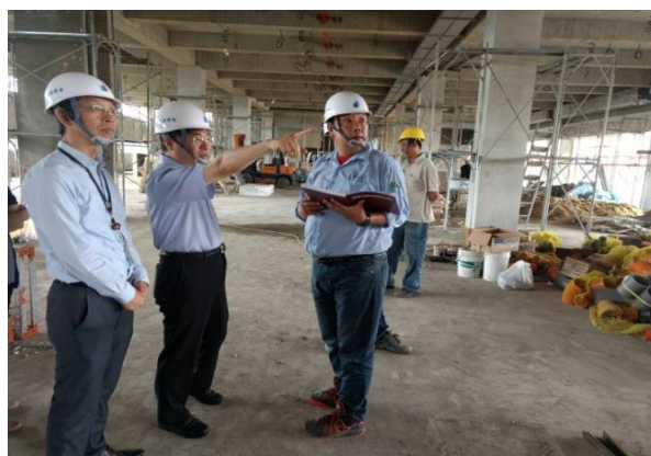
07.2017 新建工廠消防安全評估現勘輔導-黃建彰副總(左二)
